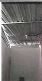
Foto 3: Instalación eléctrica en bodega.
